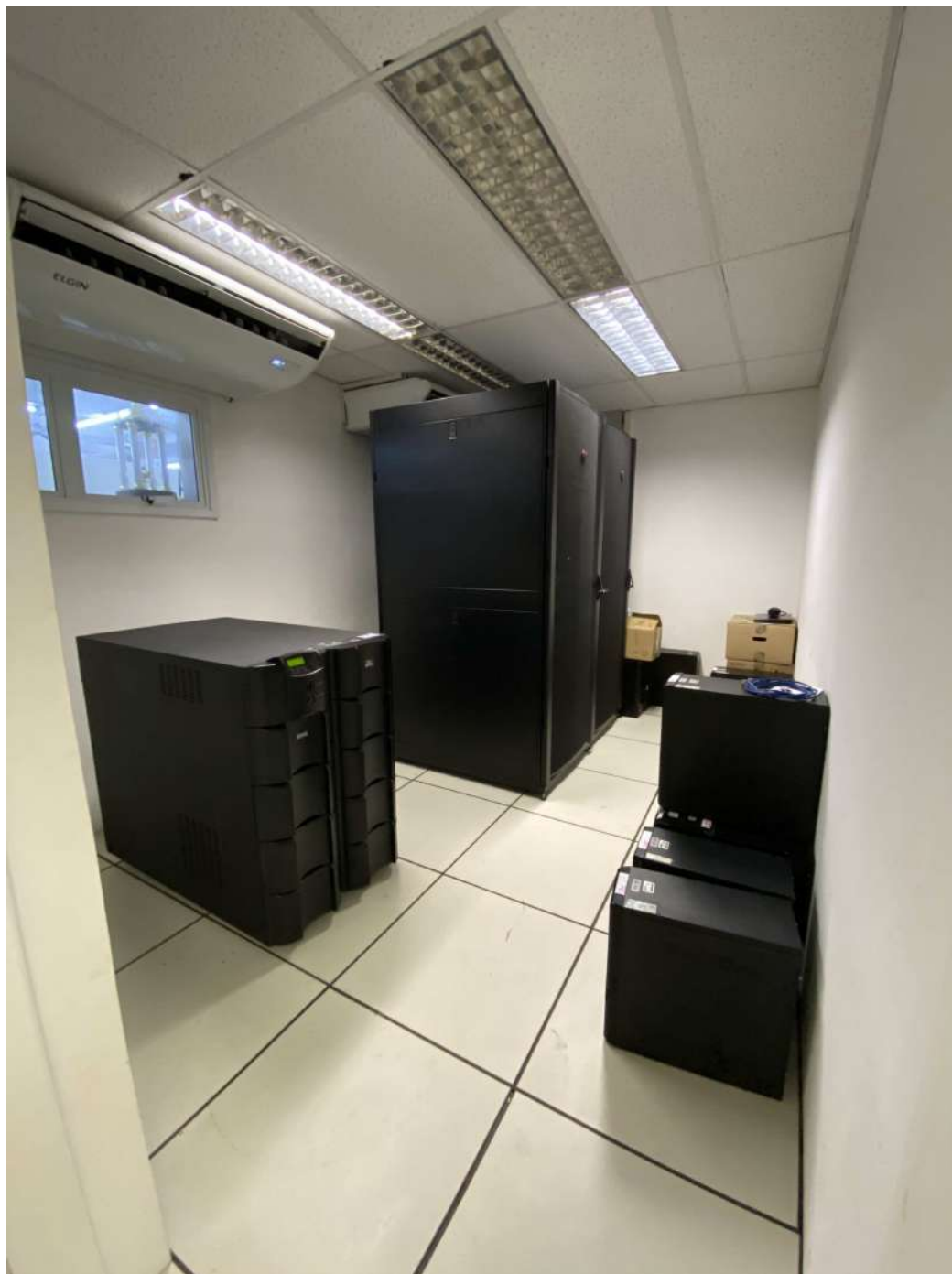
Figura 9: Data Center 02- Paço Municipal
