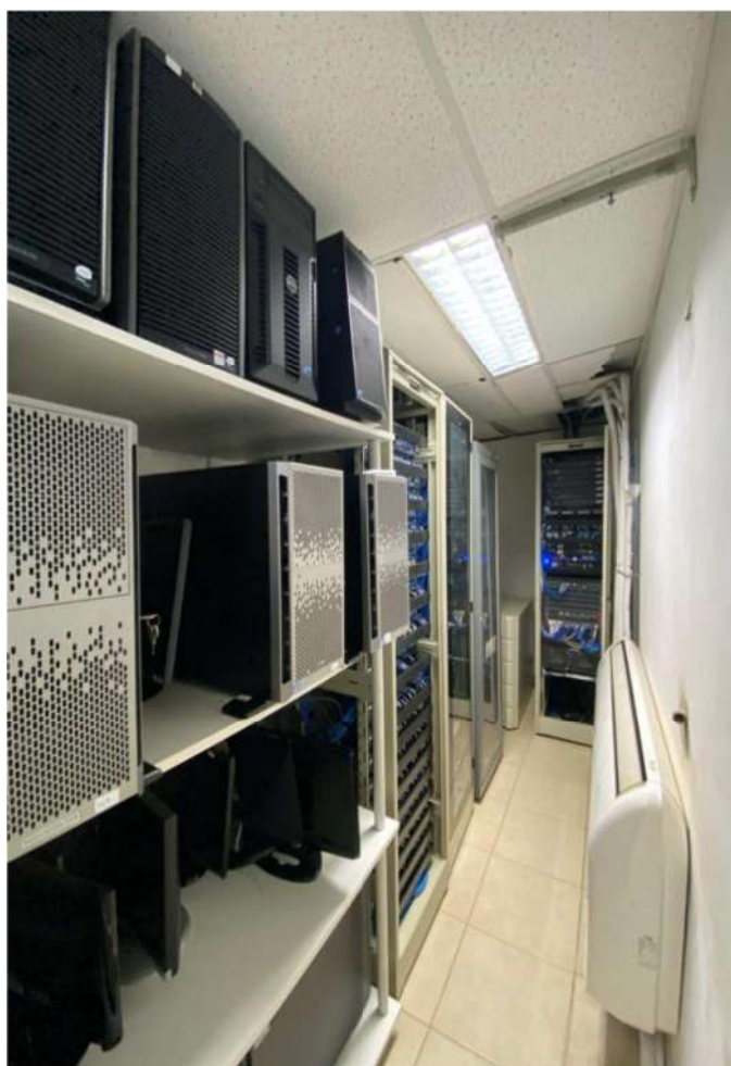
Figura 3: Data Center 01 - Paço Municipal
